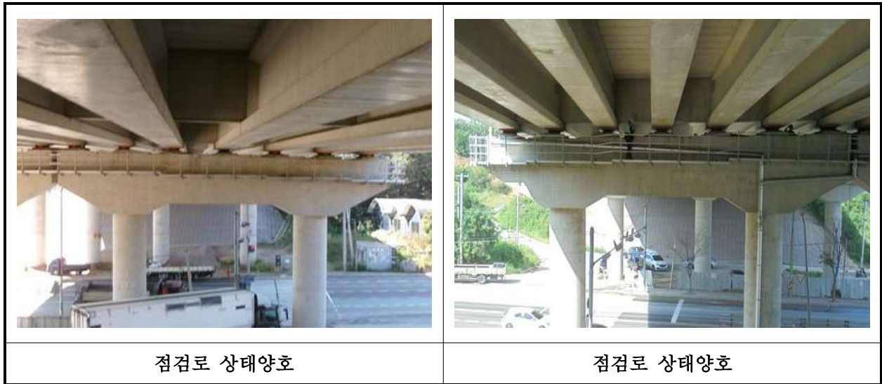
【사진 7.3.26】 교량 점검시설 손상현황
